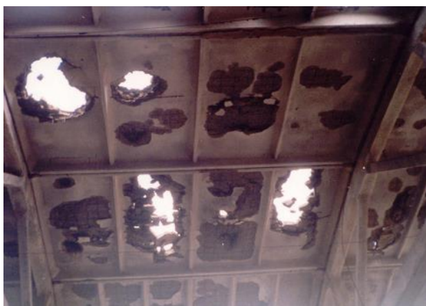
Рис. 2. Багатопролітна одноповерхова будівля, відколювання бетону.
