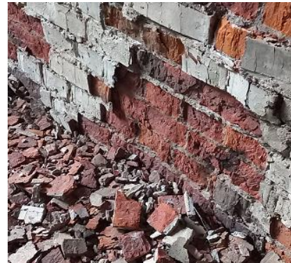
Рис. 4. Двопролітна одноповерхова будівля, відколювання цегли.
