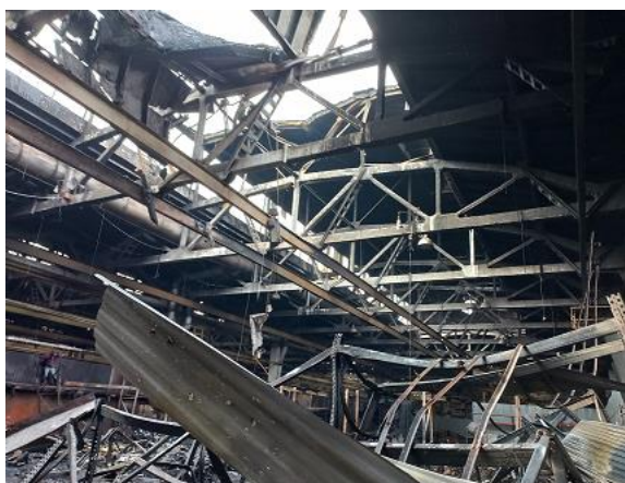
Рис. 1. Багатопролітна одноповерхова будівля, обрушення конструкції світлового ліхтаря.
