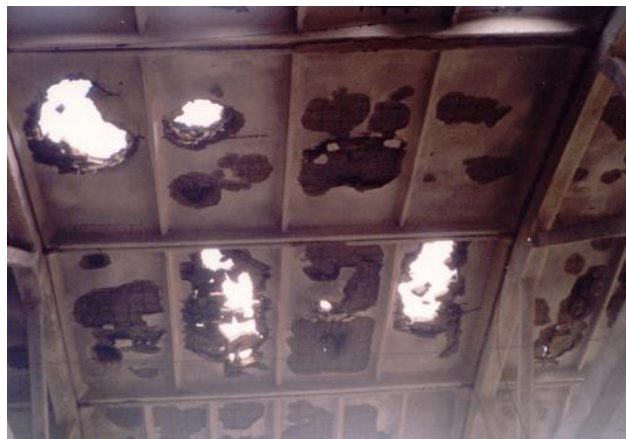
Рис. 2. Багатопролітна одноповерхова будівля, відколювання бетону.
