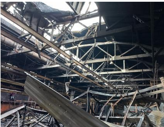
Рис. 1. Багатопролітна одноповерхова будівля, обрушення конструкції світлового ліхтаря.
