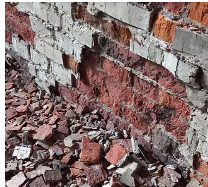
Рис. 4. Двопролітна одноповерхова будівля, відколювання цегли.
